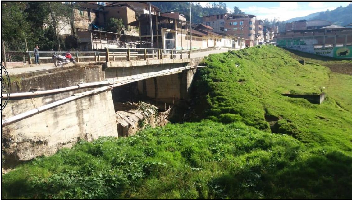
Fotografía N° 11: vista panorámica del puente, debajo del cual se crían cerdos.
